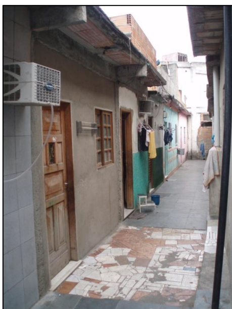
Photo 10 – Revêtement de sol discontinu dans le couloir D de l'ancien entrepôt (voir localisation du couloir sur le plan C de l'invasion « Palace » dans l' annexe 7 ).
