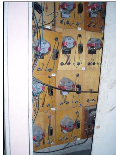
Photo 34 : Les compteurs d'électricité installés par l'entreprise « Light » dans l'immeuble principal de l'invasion.
