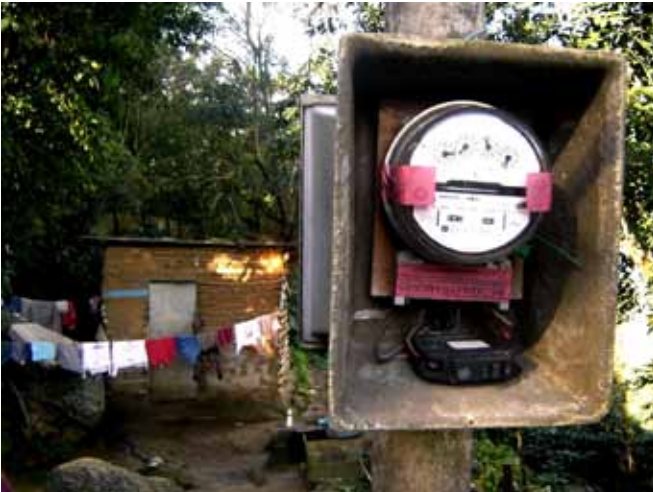
O relógio de luz instalado e o reconhecimento do direito a um endereço, com a chegada da conta de luz. Foto: Felipe Berocan Veiga, 2007.
