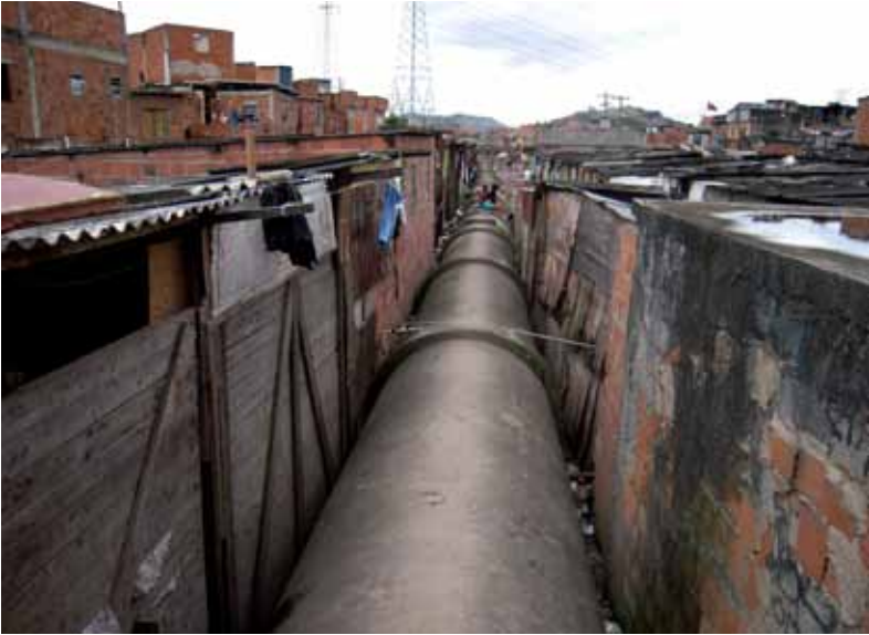
Uma adutora de esgoto atravessa Manguinhos, entre casas sem saneamento básico. Foto: Letícia de Luna Freire, 2009.
