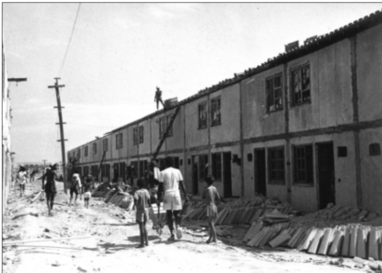
Construção das “casas novas”, substituindo os antigos “vagões”. Foto: Lúcia Maria Cardoso de Souza & Marco Antonio da Silva Mello, 1988.
