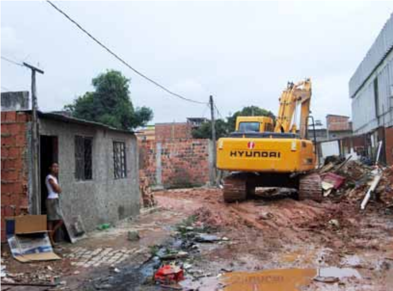
Moradora observa os trabalhos de demolição das casas na favela Embratel, em Manguinhos. Foto: Leticia de Luna Freire, 2008.
