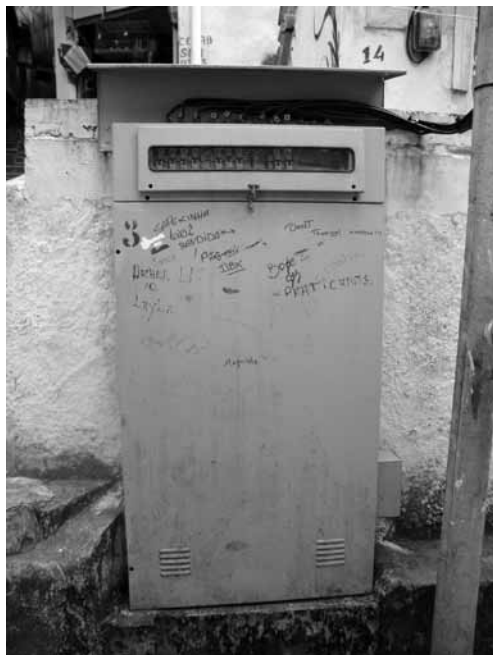
Foto 8 – Novo relógio de medição de consumo de energia elétrica instalado pela Light em 2009. Foto: Neiva Vieira da Cunha, 2010
